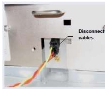
รูปที่ 10-36 แสดง Leak Sensor Cable
